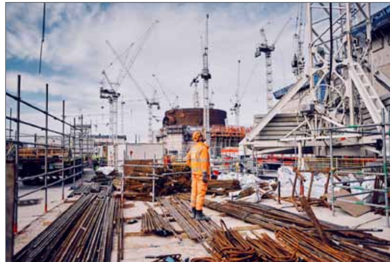
Centrale nucléaire de Hinkley Point - Hinkley Point C, chantier de construction de 2 réacteurs nucléaires de nouvelle génération (EPR), Somerset, Angleterre. © Lucille Pellerin / REA pour Les Échos
