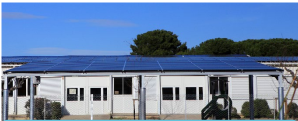
La Ville privilégie le solaire en autoconsommation – ici le préau solaire de l'école Boussiron
